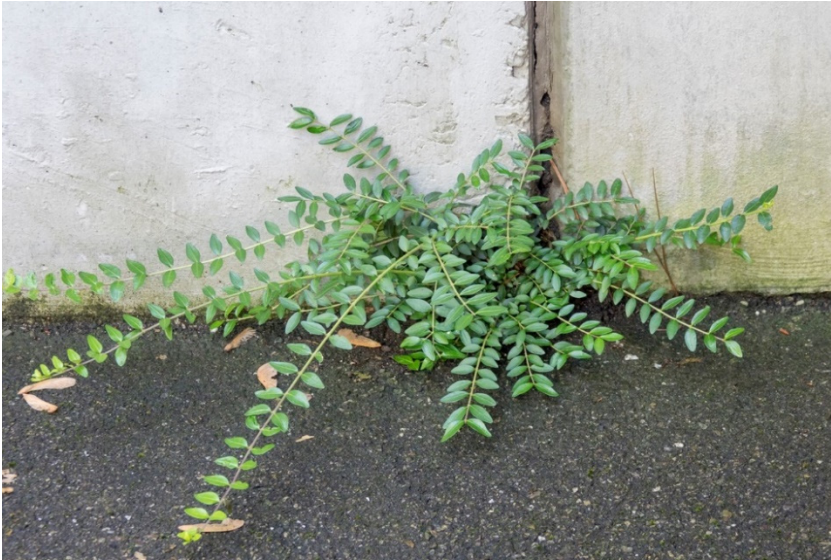
Foto 14: Pflanze, die aus dem Beton wächst
